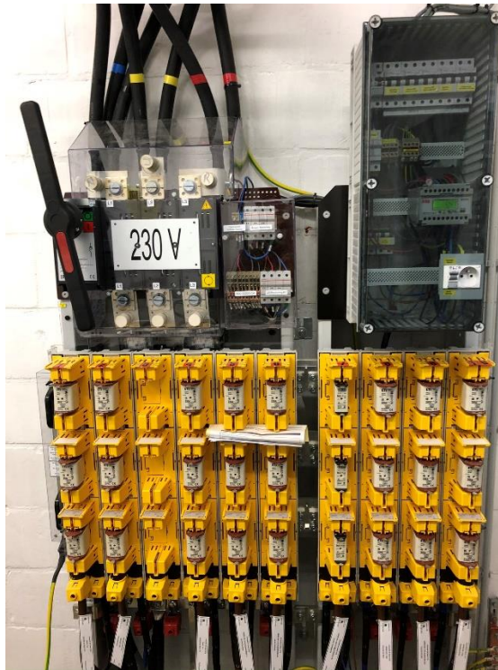
Figure 19 : Tableau Général Basse Tension (TGBT) dans une cabine réseau Sibelga
