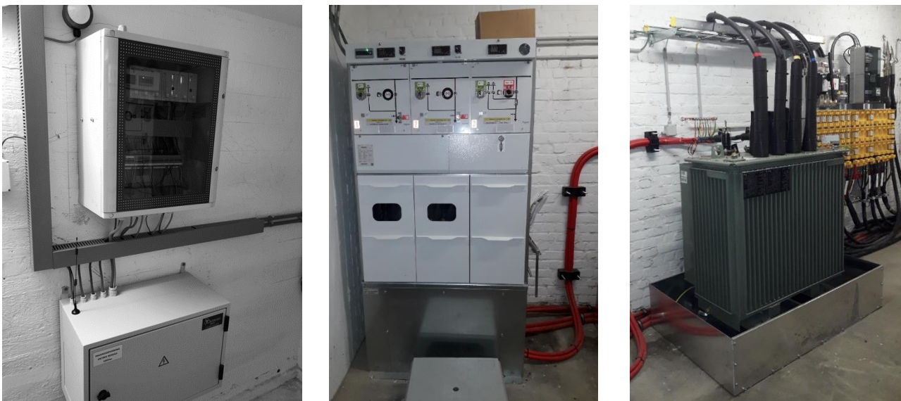
Figure 15 : Cabine réseau smart Sibelga
