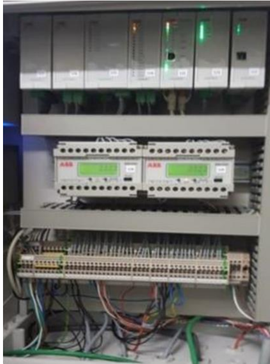
Figure 17 : Armoire de télécontrôle utilisée dans les cabines smart de Sibelga et dans les cabines HT des clients avec production \geq 1 MVA
