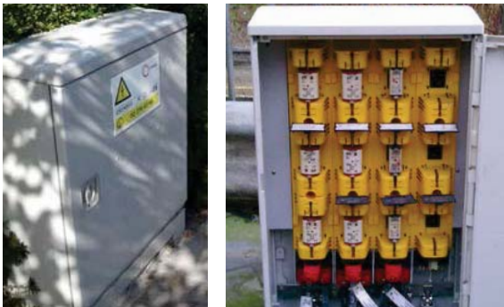
Onze laagspanningskasten (LSK) verdelen de stroom naar de klantencabines en de huishoudelijke klanten. In deze kasten zitten de smeltveiligheden die het net beschermen.
