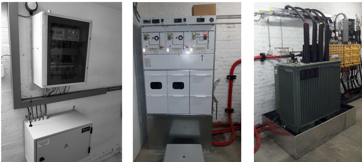
Figure 15 : Cabine réseau smart Sibelga
